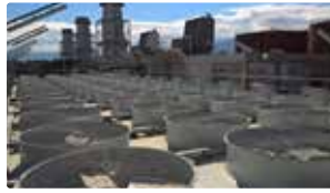
LNG fin fans
