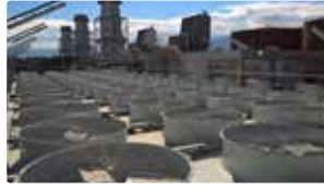
LNG fin fans
